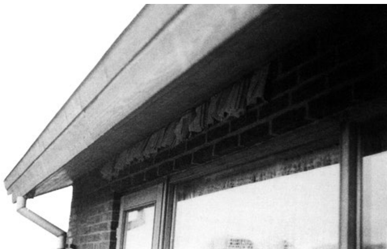
Figur 1. Den lodrette forankring af dette tag var ikke tilstrækkelig, så under en kraftig storm ledte taget en smule, men det faldt på plads igen. Gardinet og tagnedløbet bevidner hændelsen.
