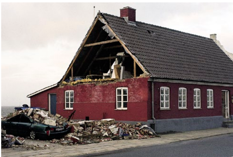
Figur 3. En ejendom som ikke har kunnet modstå belastningen under stormen.
