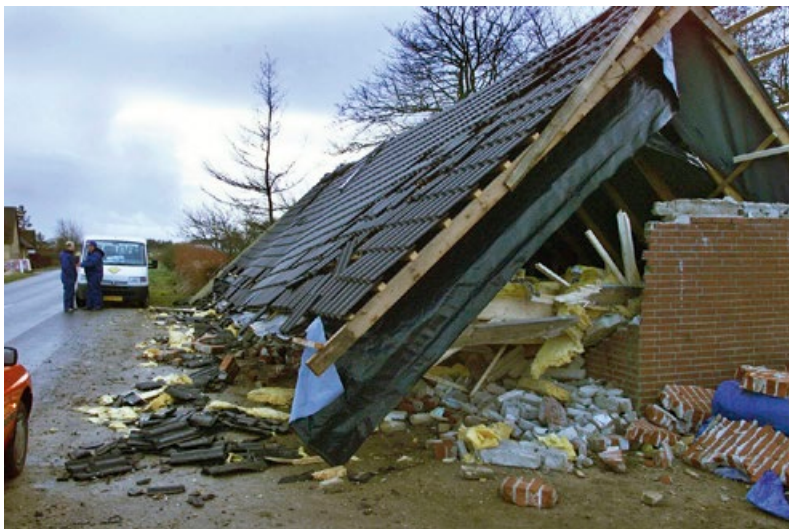
Figur 2. Ejendommen var ikke tilstrækkelig stabil, da den blev opført, så under en storm kollapsede ejendommen. Foto: Kim Agersten.
